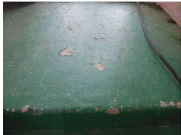
〔검수실 : 바닥슬래브 도장손상〕
