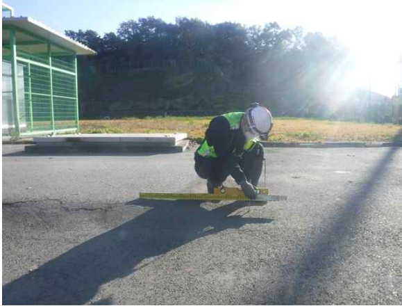
〔구내도로 : 포장콘크리트 침하〕
