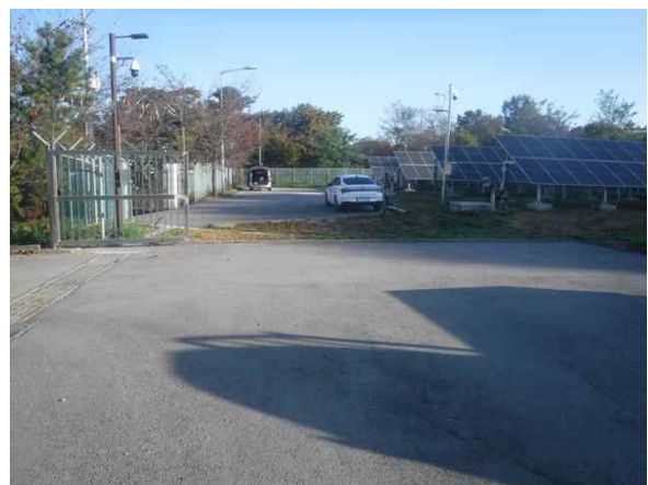
〔구내도로 : 포장콘크리트 균열〕
