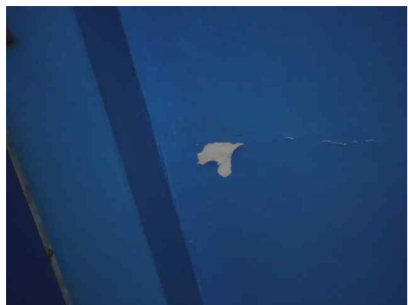
〔배수지 2호지 상부슬래브 : 도장손상〕
