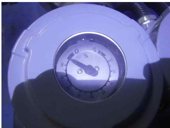
[전동밸브 개도계 : 상태양호]
