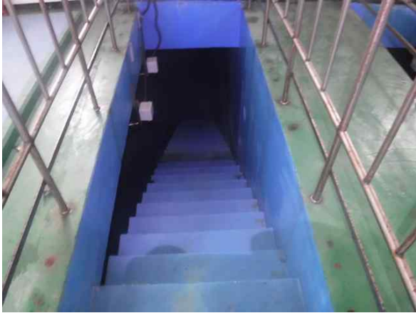
〔배수지 1호지 : 안전난간 미설치〕
