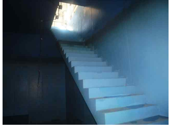
〔배수지 2호지 : 안전난간 미설치〕
