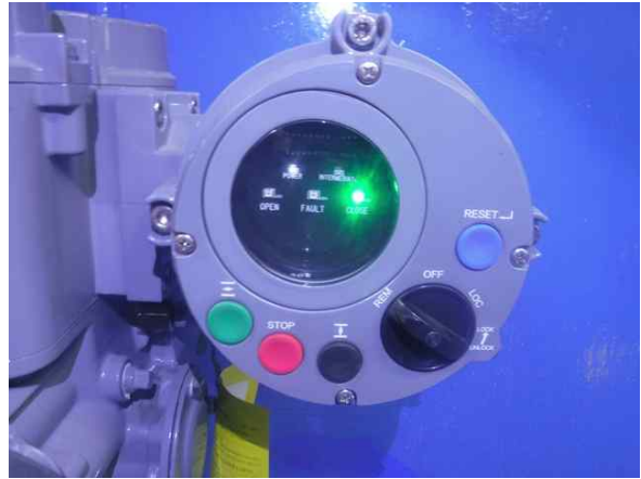
[전동밸브 : 작동 상태양호]
