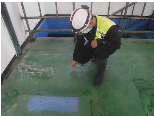
〔검수실 : 바닥슬래브 들뜸〕
