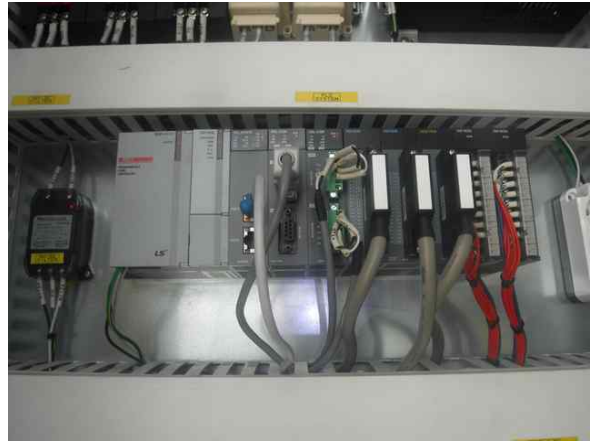
〔현장제어반 : 전선열화 상태양호〕
