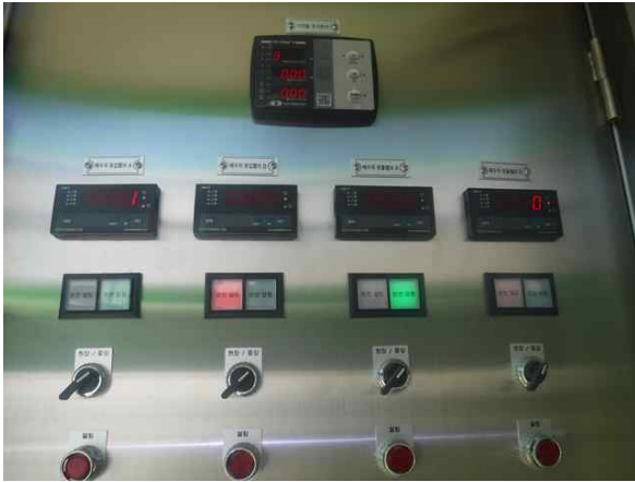
〔현장제어반 : 작동 상태양호〕
