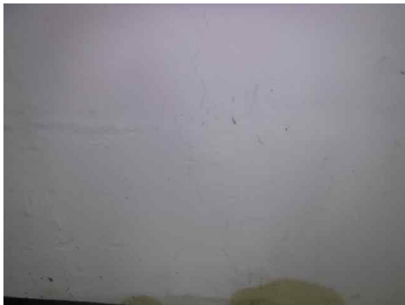
〔검수실 : 벽체 균열〕
